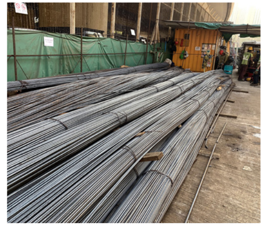
承建商存放建築物料的地方，須注意衛生問題。
