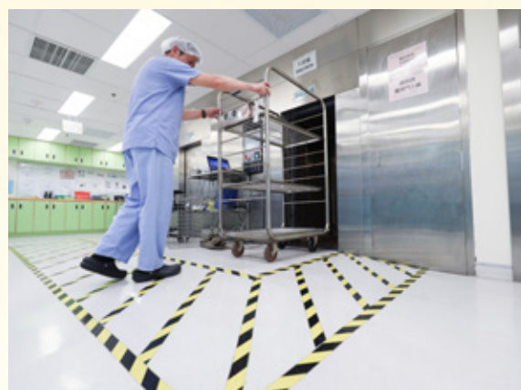
現時將爐車推入滅菌爐前，要先推上一個小斜台，設計並不理想。
