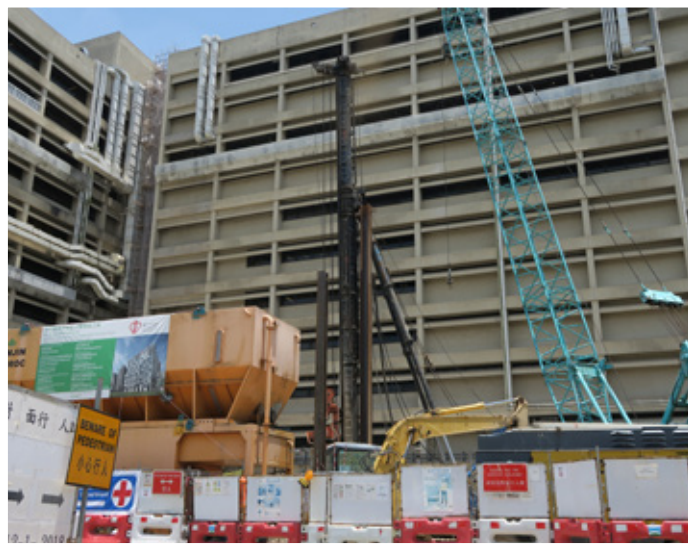
擴建手術室大樓首階段工程正在施工中，為大樓奠定地基。
